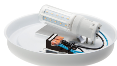
Przyłączenie zasilające w oprawie oświetleniowej
